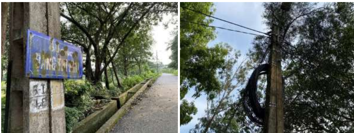
Hình 67. Hệ thống thoát nước và dây dẫn điện, chiếu sáng trên tuyến phố Đặng Thị Nho.
