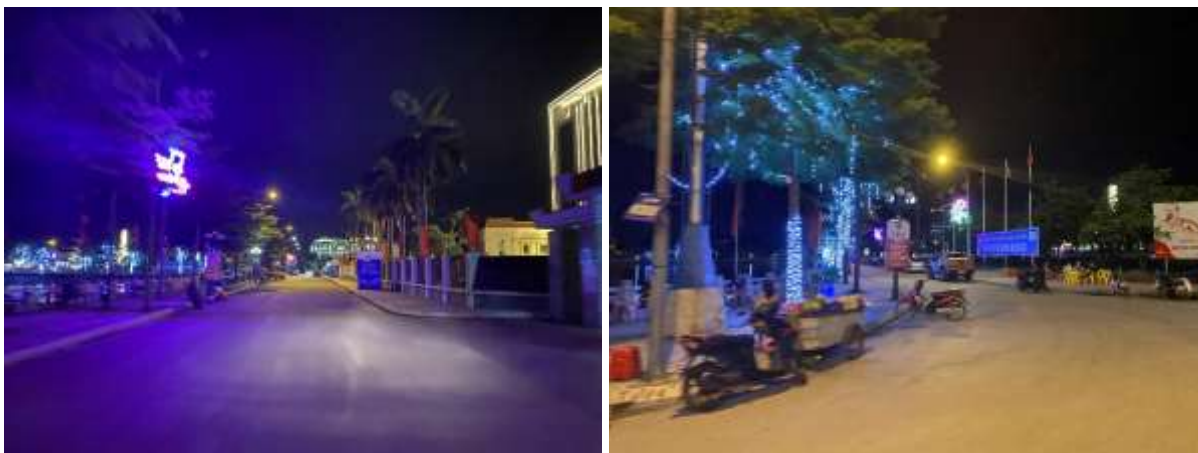
Hình 61. Hệ thống đường dây dẫn điện, thông tin liên lạc và chiếu sáng trên tuyến phố Hồ Công Dự.
