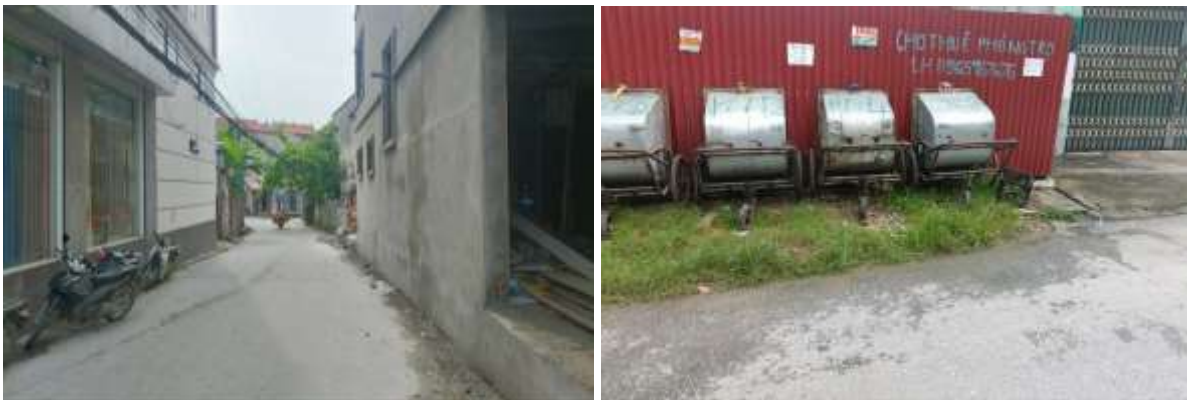
Hình 109. Chất lượng mặt đường trên tuyến phố Ninh Khánh.
