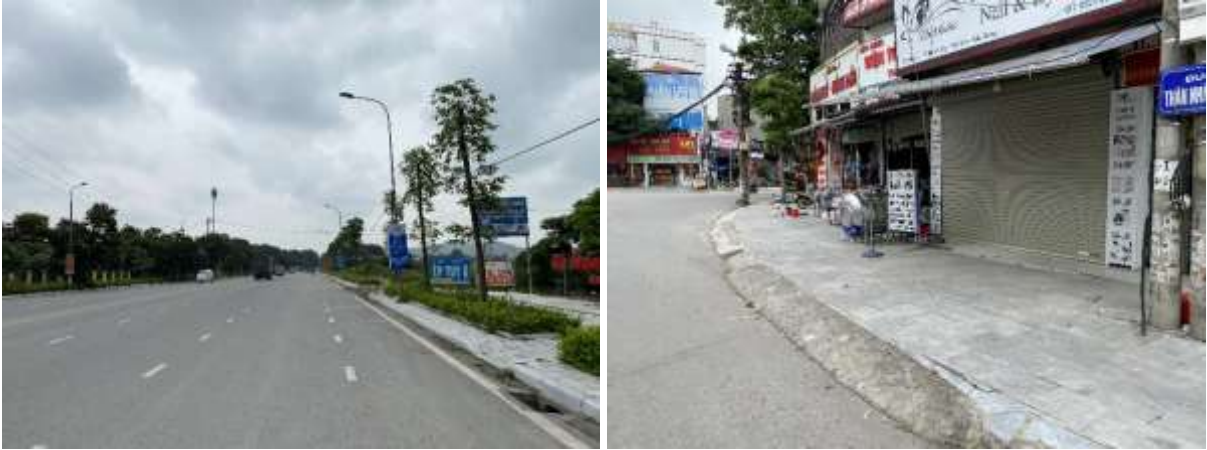
Hình 19. Chất lượng mặt đường, vỉa hè và vỉa thực trạng xây thêm gờ tự phát trên tuyến phố Thân Nhân Trung.
