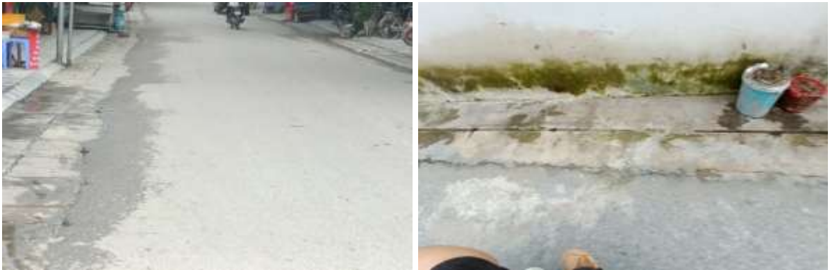
Hình 83. Chất lượng mặt đường trên tuyến phố Sen Hồ.
