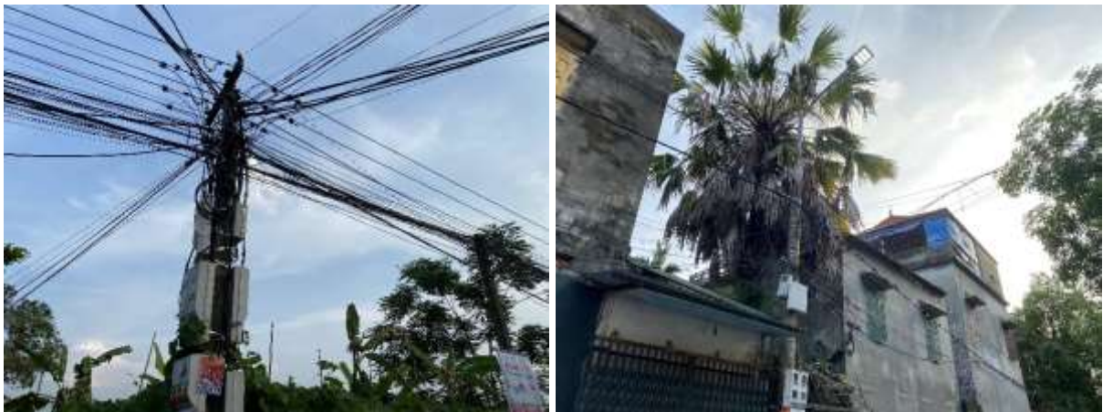
Hình 53. Hệ thống đường dây dẫn điện, thông tin liên lạc và chiếu sáng trên tuyến phố Nguyễn Hồng.
